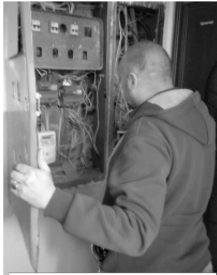
Мастер по обслуживанию зданий и сооружений Дмитрий Сорокин проводит осмотр электросчетчиков потребителей.
